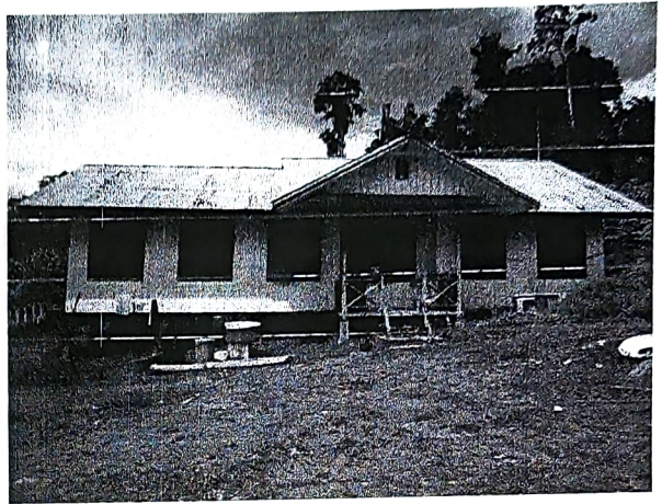
Rumah Paramedis : 2 Unit Kondisi : Rusak Ringan
